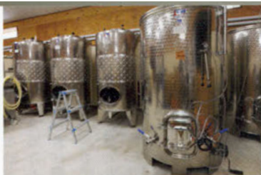
農園内のニンジン選果場をワイナリーに改装し、タンクやプレス機を設置した
